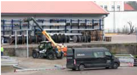
Neubau Stadtwerke – Unterstand– Notstromaggregate
